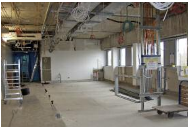
Noch Baustelle, aber schon bald Hightech-Bereich der Weltklasse: Im Klinikum entsteht derzeit ein Hybrid-OP-Saal.
