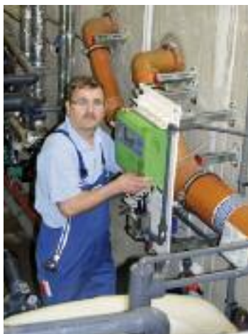
Die Wartung und Überprüfung moderner Anlagen ist ein Aufgabenschwerpunkt von Uwe Wernecke.
