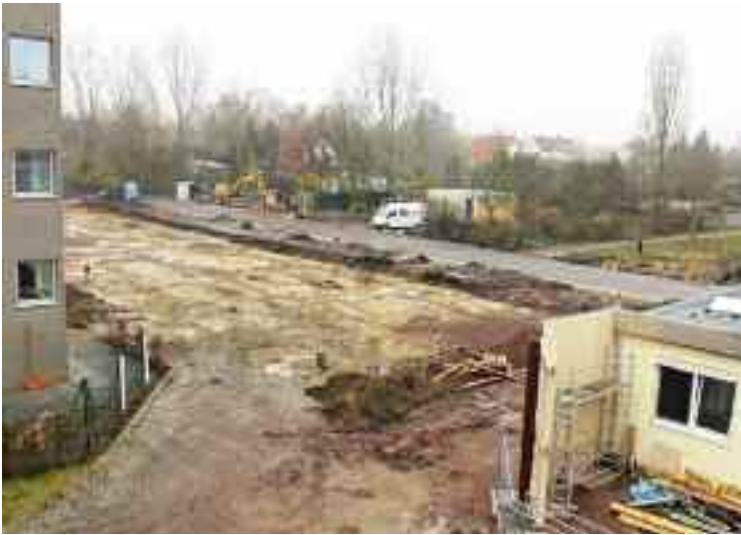
Bevor im Frühjahr der Grundstein gelegt werden kann, sind noch etliche Vorbereitungen notwendig.
